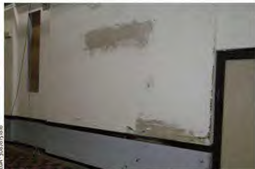
Les infiltrations d'eau provoquent des dégâts dans les murs. La toiture de la salle des Guichoux doit être complètement refaite.
